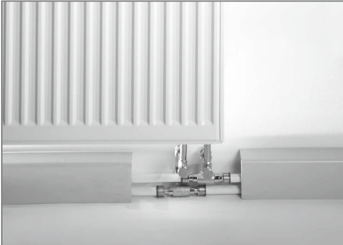
Heizkörperanschluss aus der Sockelleiste
