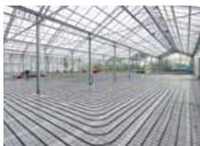
Garden Center Overvecht - Tilburg (NL) 2.100 m 2 di pannello piano 7.000 m di tubo
