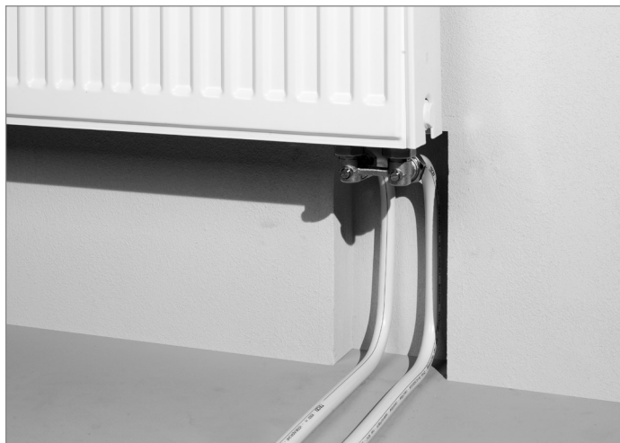
Heizkörperanschluss aus der Wand
