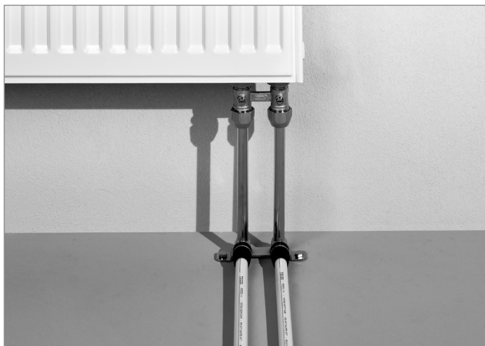
Heizkörperanschluss mit HK-Montagegarnitur, Bodenmontage – an den Hahnblock angeschlossen
