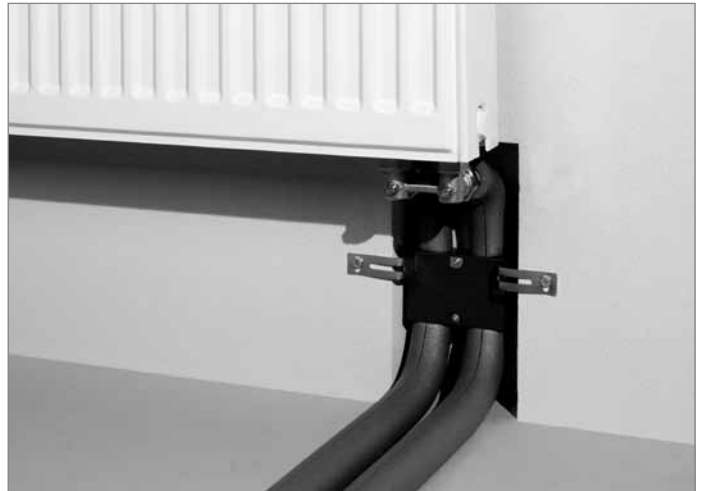
Heizkörperanschluss mit Montagemodul – an den Hahnblock angeschlossen
