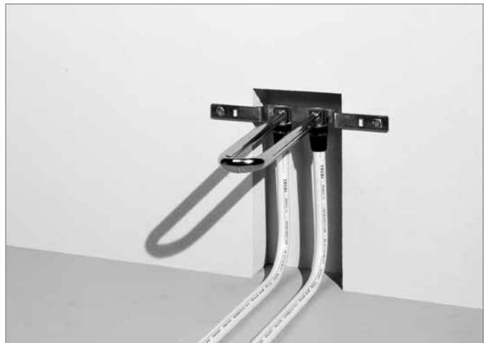
Heizkörperanschluss mit HK-Montagegarnitur, Wandmontage – bereit zum Abdrücken
