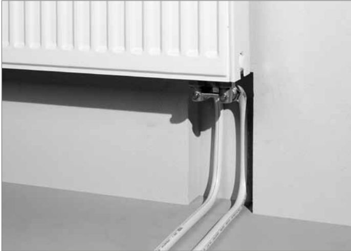
Heizkörperanschluss aus der Wand
